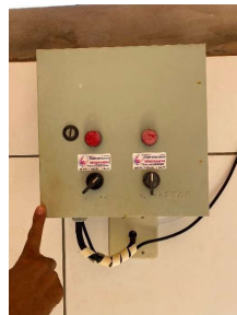
Figura 22 -Quadro de comando
