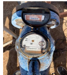
Figura 19 - Medidor destacando-se o totalizador de volumes captados.
