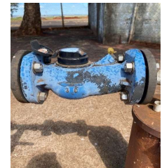
Figura 20 - Detalhe do Medidor Woltmann (quebrado).
