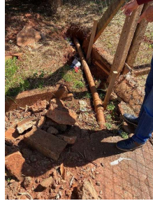
Figura 7 - Tubulação de PVC - PBA DN 80 mm (rede elevatória)
