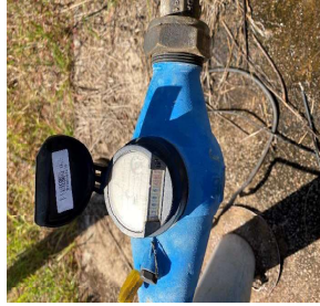
Figura 30 - Vista do macromedidor de vazão dos volumes captados.
