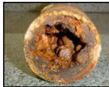
Figura 45 - Ilustração de secção de tubulação incrustada
