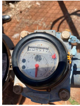
Figura 5 - Destaca-se o macromedidor com totalizador de volumes captados.
