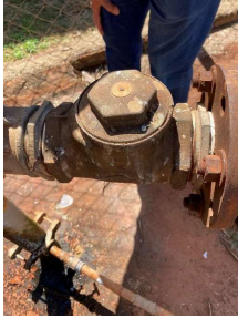
Figura 6 - Válvula de retenção no cavalete de recalque.
