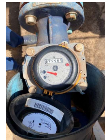
Figura 12 - Macromedidor, destacando-se o totalizador de volumes
