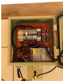
Figura 21 – Quadro de comando
