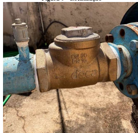
Figura 11 - Válvula de retenção no cavalete
