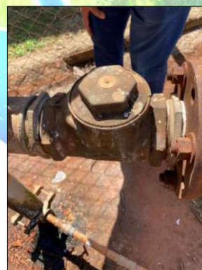
Figura 18 - Válvula de retenção no cavalete de recalque. Fonte: Prefeitura Municipal, 2023.
