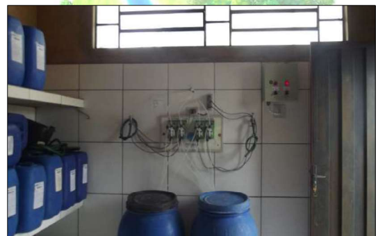
Figura 41 – Dosadores de cloro e flúor
