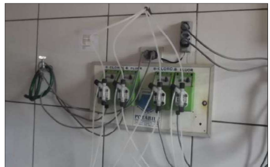
Figura 40 – Dosadores de cloro e flúor
