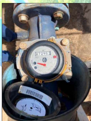
Figura 24 – Macromedidor, destacando-se o totalizador de volumes. Fonte: Prefeitura Municipal, 2023.
