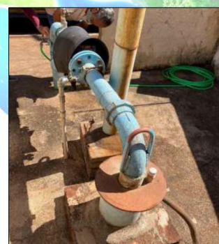
Figura 22 – Dispositivos; Tubo medidor de nível, laje de proteção sanitária. Fonte: Prefeitura Municipal, 2023.
