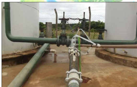
Figura 39 – Tratamento da água com cloro e flúor na entrada dos reservatórios
