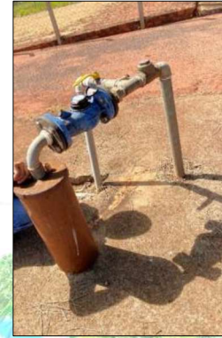
Figura 29 – Dispositivos, tubo de medição de nível, laje de proteção sanitária. Fonte: Prefeitura Municipal, 2023.
