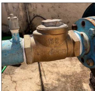
Figura 23 – Válvula de retenção no cavalete. Fonte: Prefeitura Municipal, 2023.
