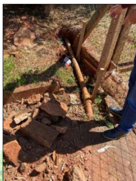
Figura 19 - Tubulação de PVC - PBA DN 80 mm (rede elevatória). Fonte: Prefeitura Municipal, 2023.
