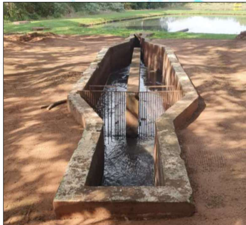
Figura 47 – Sistema de Gradeamento, Desarenador e Calha Parshall Fonte: Prefeitura Municipal
