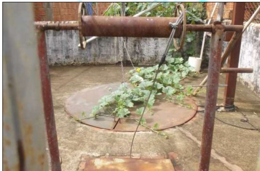
Figura 48 – Estação Elevatória de Esgoto - Rua Rui Barbosa Fonte: Prefeitura Municipal
