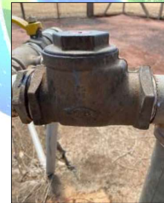
Figura 30 – Válvula de retenção. Fonte: Prefeitura Municipal, 2023.
