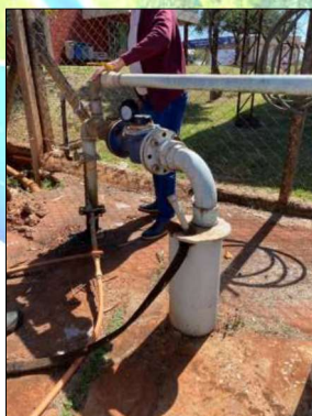
Figura 16 - Dispositivos: laje de proteção sanitária e tubo para medição de nível. Fonte: Prefeitura Municipal, 2023.
