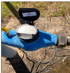
Figura 38 – Vista do macromedidor de vazão dos volumes captados.
