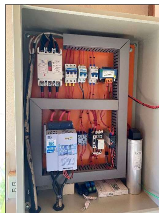
Figura 25 – Quadro de comando. Fonte: Prefeitura Municipal, 2023.
