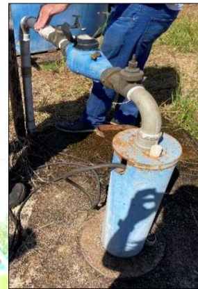
Figura 36 – Dispositivo: Laje de proteção sanitária e tubo medidor de nível.
